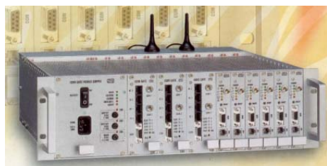
Rack 19" Ateus équipé de modules monocanal analogiques et de modules bicanal numériques
